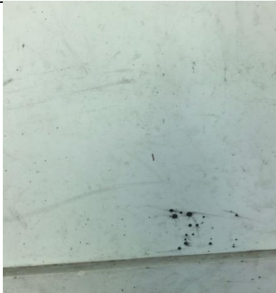
Gambar 21 Coretan di dinding
