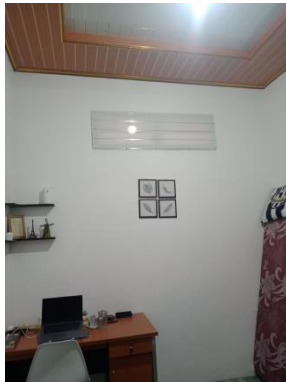
Gambar 7. Tidak Terdapat Jendela Di Kamar Tidur
