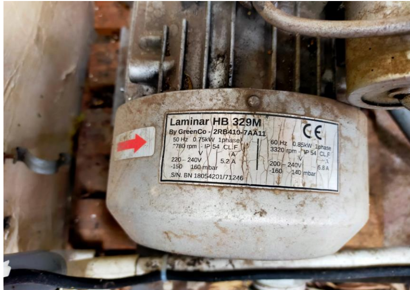
Gambar 13 Ada 2 Blower yang di gunakan pada IPAL Rumah Sakit Kartini
