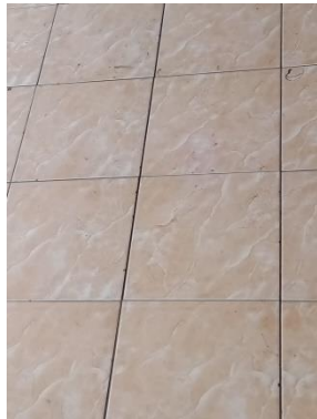
Kondisi lantai dapur
