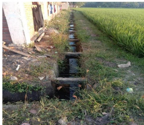
Saluran pembuangan SPAL( Sarana pembuangan air limbah)
