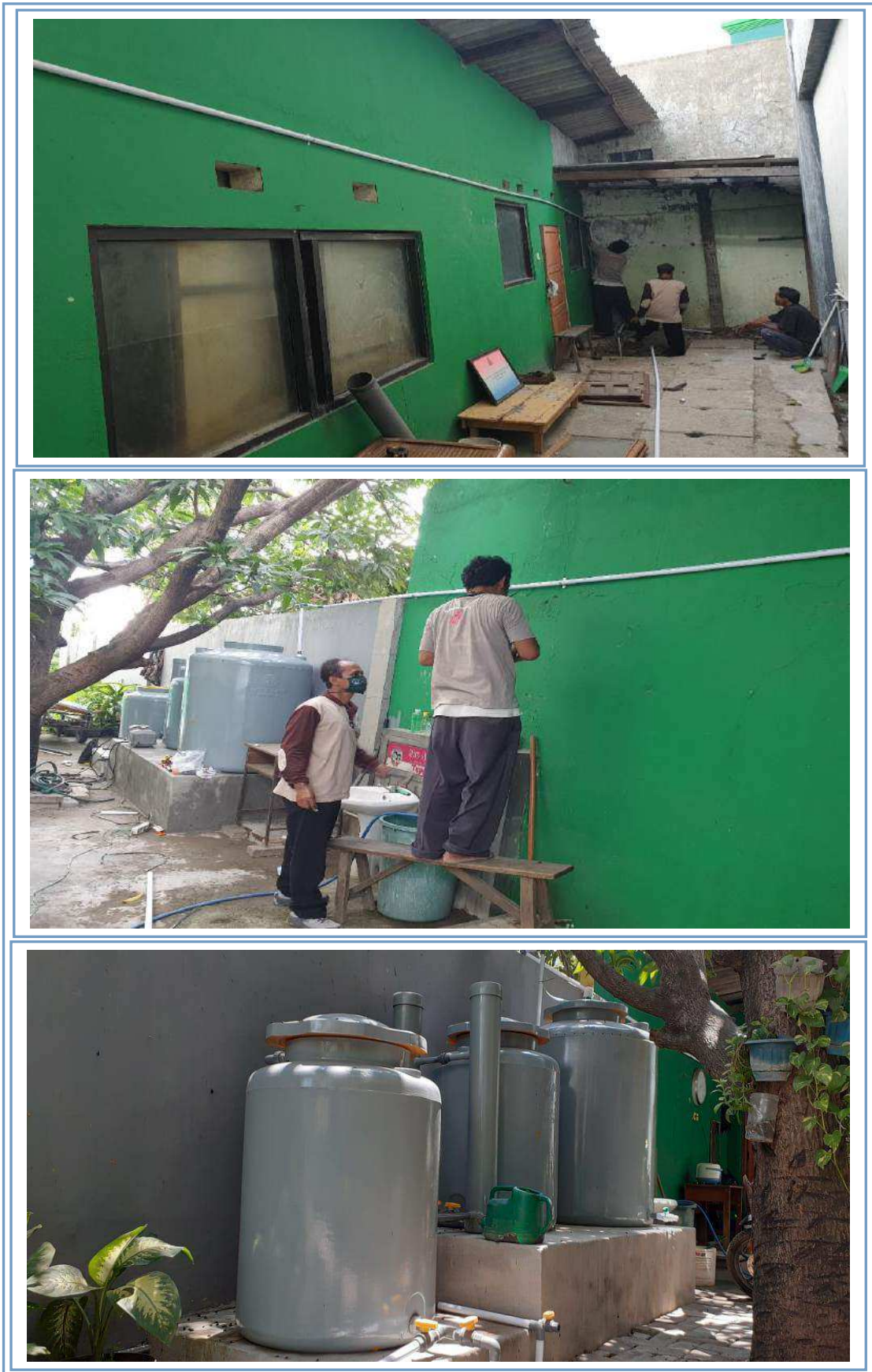
Foto 6. Instalasi Perpipaan Dari Tanki Pengumpul Ke Unit Pengolah Air Limba
