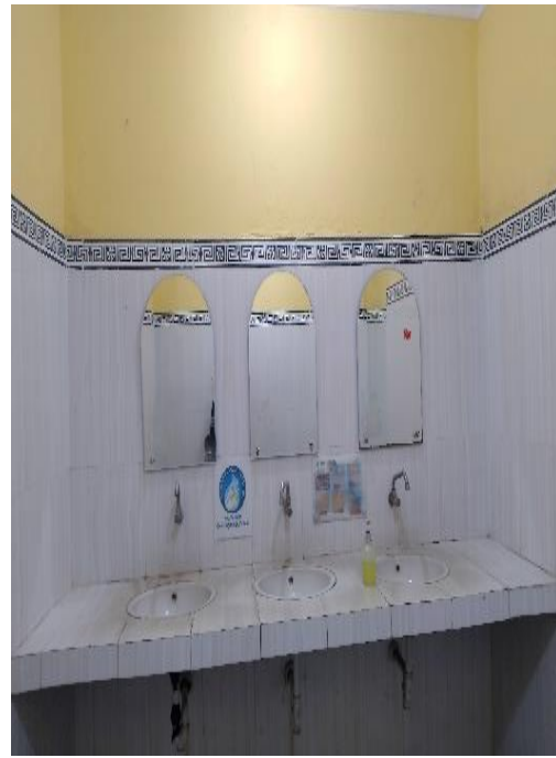
Kondisi wastafel pengunjung
