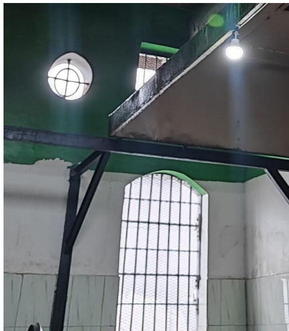
Gambar 6 Ventilasi udara area pengolahan dapur
