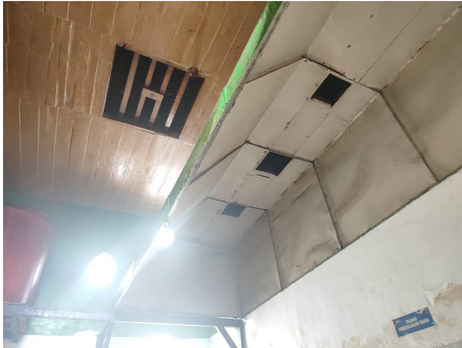
Gambar 17 Pembuangan asap dapur di area pengolahan pangan
