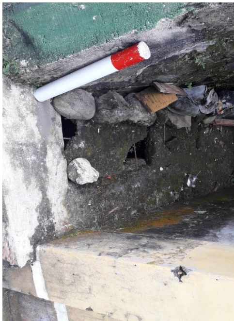
Saluran pembuangan tertutup tetapi rusak
