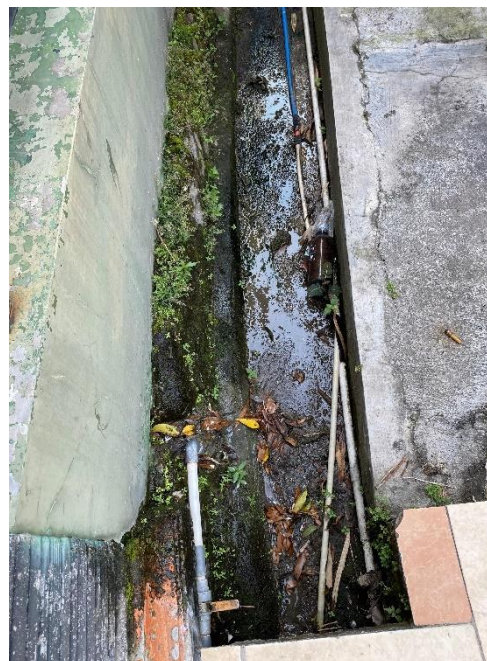
Saluran pembuangan terbuka ada genangan air
