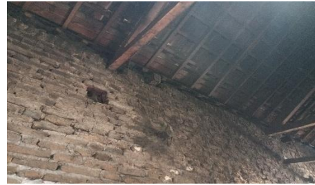
Kondisi langit-langit, dinding
