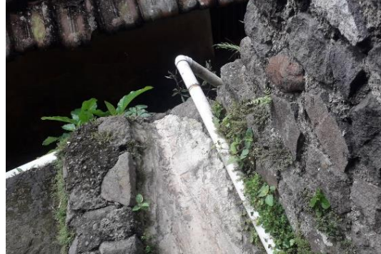
Pembuangan limbah menggunakan pipa
