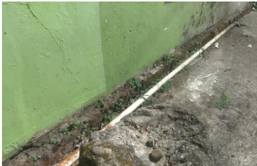
Pipa air bersih dan air limbah tidak bersilangan
