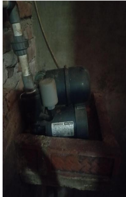
Mesin Pompa Untuk Pengambilan Air Bersih (Sumur Gali)
