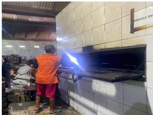
Atap tempat pengolahan makanan yang berbahan asbes dan tidak rapat vektor
