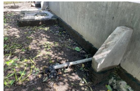
Gambar 6. Kondisi Teknis Bangunan Sumur Gali pada Sumber Pencemar Pembuangan Air Limbah
