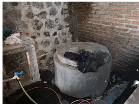
Gambar 12 sumur tidak memiliki lantai
