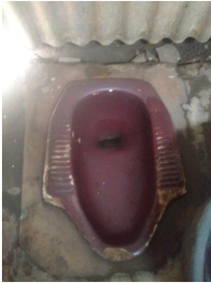
Gambar 5. Kondisi jamban yang tidak sehat
